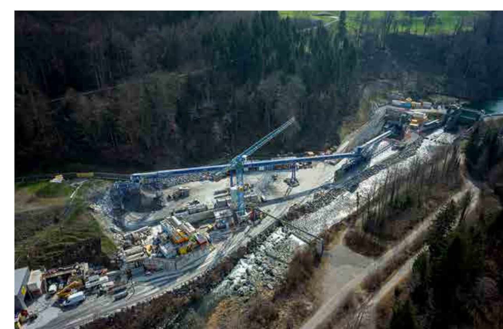
Baustelle des Auslaufbauwerks in Alpnach, von welcher sich die Tunnelbohrmaschine nach Sachseln frässt. Bild: durrair.ch
